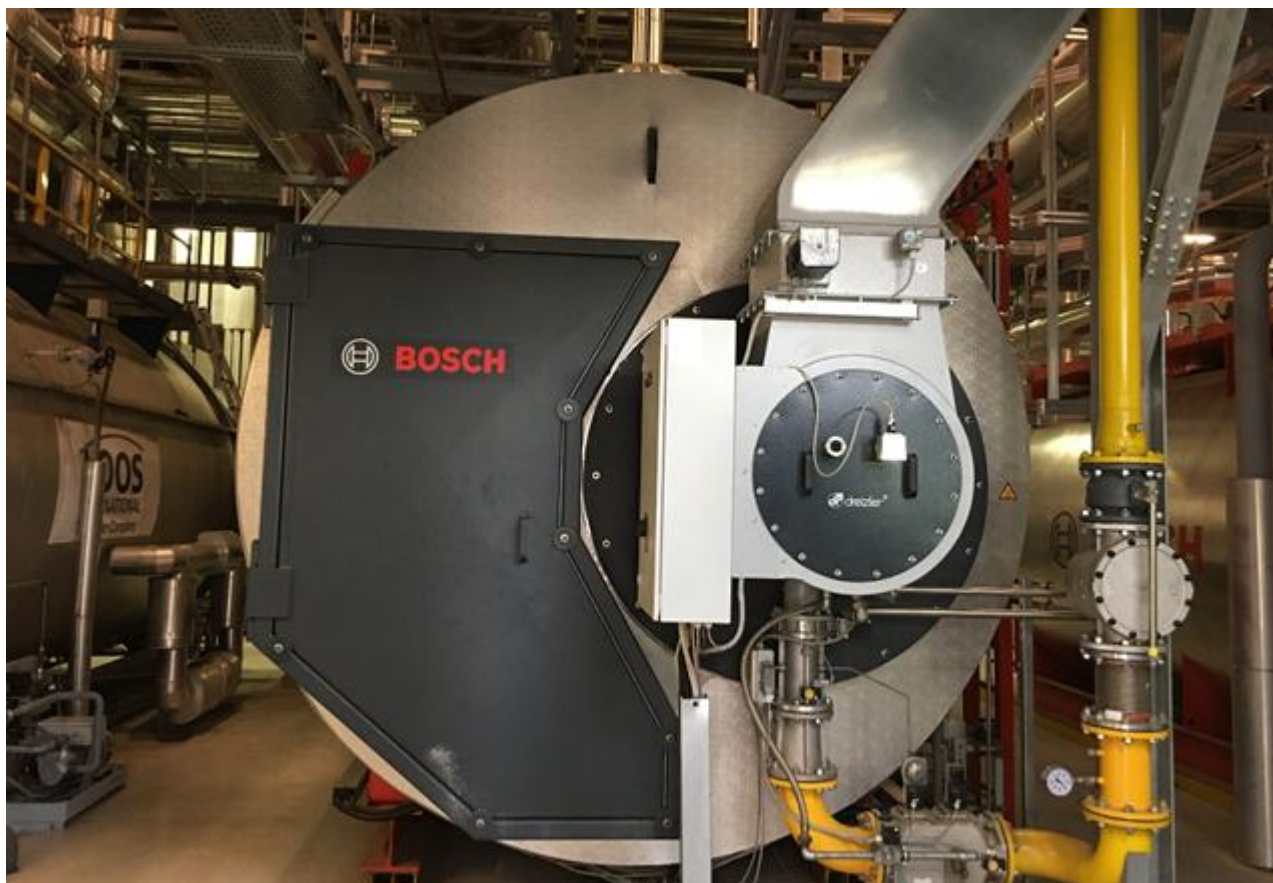
Figura 2 - Caldaia Ausiliaria a Vapore
