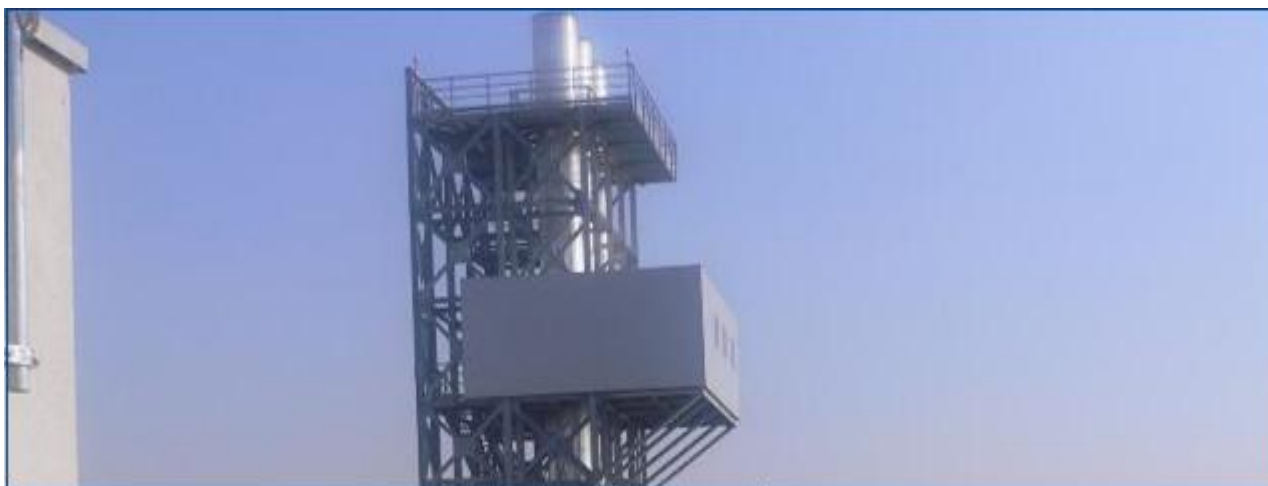
Figura 8 - Camini dei motori cogenerativi
